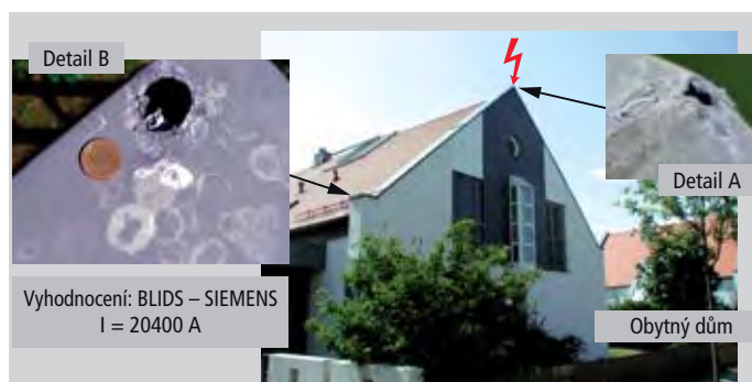
Obrázek 5.1.4.2 Příklad poškození plechové krytiny
