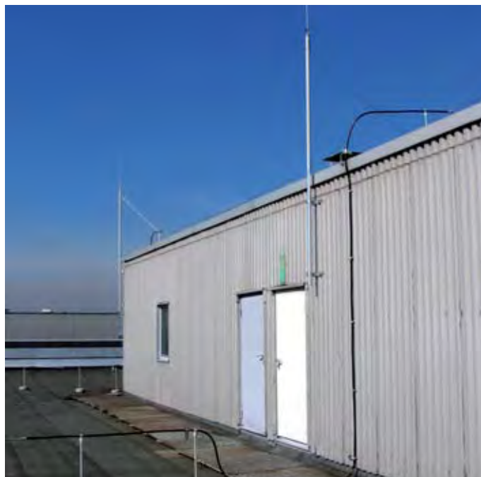
Obrázek 5.2.4.9 Instalace vodiče HVI s koncovkou
