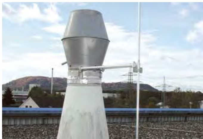
Obrázek 5.1.8.3 Jímací tyč s izolovaným držákem
