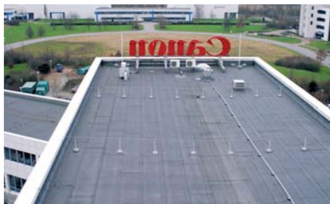
Obrázek 5.1.8.9 Jímací soustava; Zdroj: Ochrana před bleskem Wettingfeld, Krefeld
