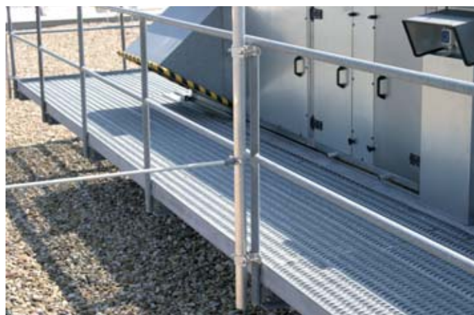
Obrázek 5.1.8.12 Podpůrná trubka DEHNiso-Combi připevněná k zábradlí
