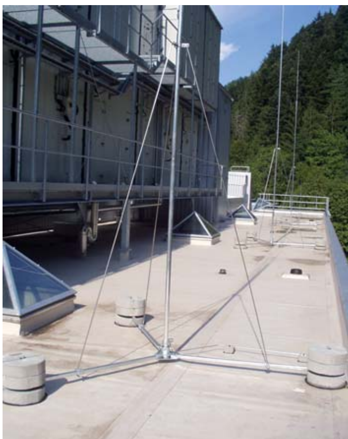
Obrázek 5.1.8.7 Oddálená jímací soustava pro střešní nástavby
