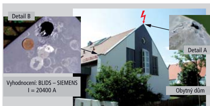
Obrázek 5.1.4.2 Příklad poškození plechové krytiny
