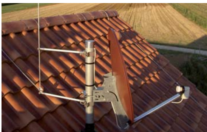
Obrázek 5.1.2.5 Anténa s jímací tyčí na izolovaných držácích
