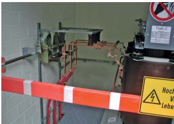
kobka vn s transformátorem
